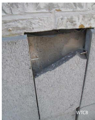
1 | Scheuren tussen de verankeringen.
