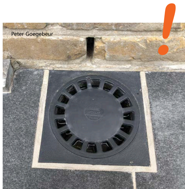
2 | Voegbeeld rondom een afvoerkolk (aanvaardbaar indien de breedte van de voeg rondom de klokput constant is en maximaal 2 mm groter of kleiner is dan de overeengekomen breedte).
