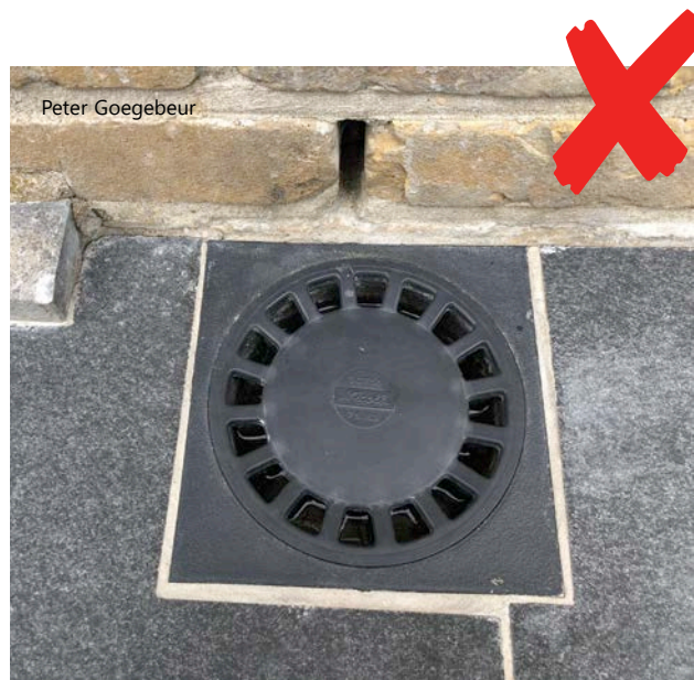
1 | Asymmetrisch voegbeeld rondom een afvoerkolk (niet aanvaardbaar).
