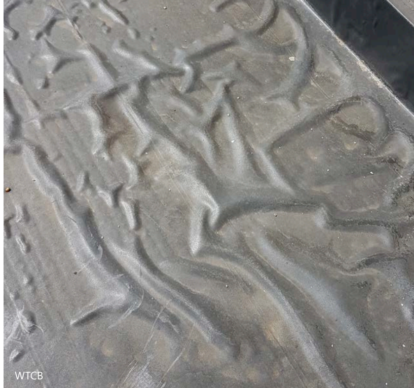
2 | Blaasvorming tussen de isolatie en de afdichting ten gevolge van ingesloten solventen.
