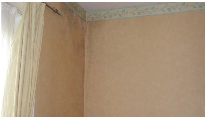
3 | Schimmelvorming op de binnenafwerking
