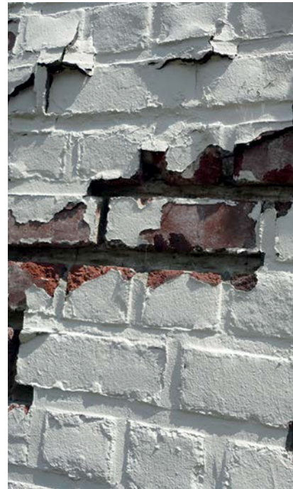
2 | Voorbeeld van schade ten gevolge van vochtophoping in de baksteen: loskomen van de verf en vorstschade ter hoogte van de voegen en de baksteen
