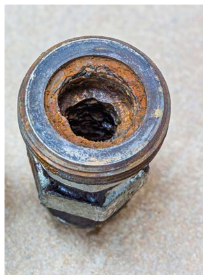
4 Afzettingen van ijzeroxides in de leidingen
