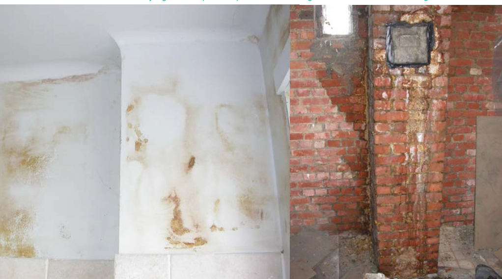
1 en 2 | Verschijning van vochtplekken op de binnenafwerking en aan de omtrek van het rookgasafvoerkanaal
