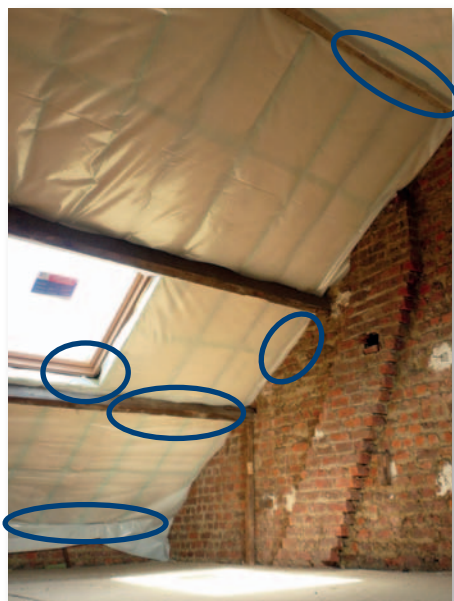
Afb. 1 Voorbeeld van een onvoldoende luchtdichte dakconstructie in een rijwoning als gevolg van een onzorgvuldige uitvoering.
