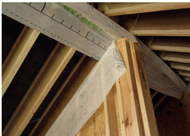
Afb. 6 Aansluiting van een binnenmuur en een nok op het dakvlak. De continuïteit van het luchtscherm wordt gerealiseerd met behulp van een wachtfolie.
