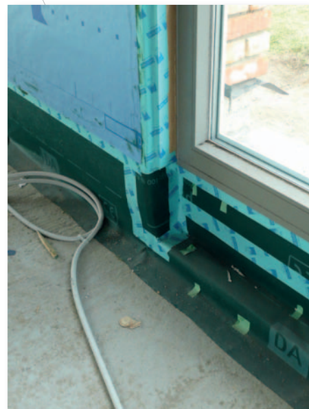
Afb. 2 Aansluiting van een houtskeletwand op een betonnen vloerplaat door middel van een strook kunststoffolie.
