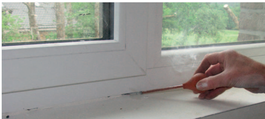
Afb. 3 Opsporing van luchtlekken wanneer het gebouw in onderdruk geplaatst wordt tijdens een pressurisatieproef.
