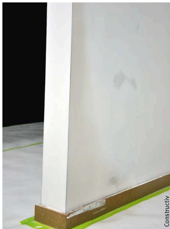
Afb. 1 Aanwezigheid van vocht in een bepleisterde muur.
