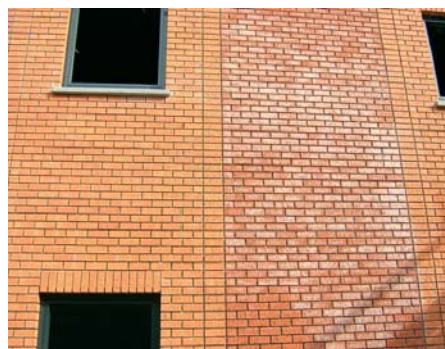
Gebouw waarbij er zoutuitbloeiingen voorkomen op de rode baksteen, maar niet op de oranje.
