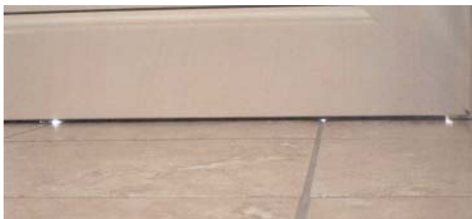
Afb. 3 Onderbreking van de guillotineplint aan de uiteinden en afwezigheid van contact ter hoogte van de voegen tussen de tegels.
