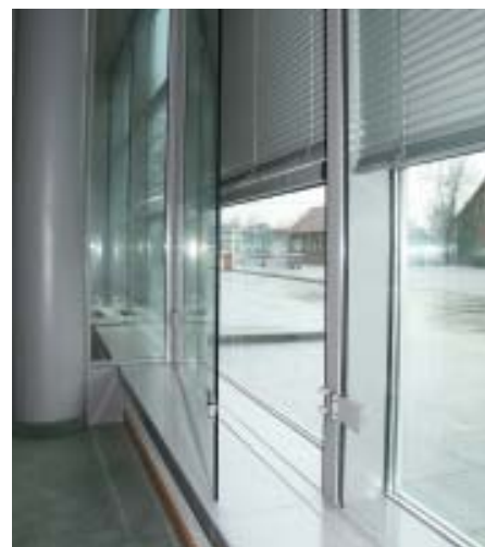
Afb. 1 Dubbele gevel, die per verdieping gecompartmenteerd is en mechanisch geventileerd wordt met binnenlucht.
