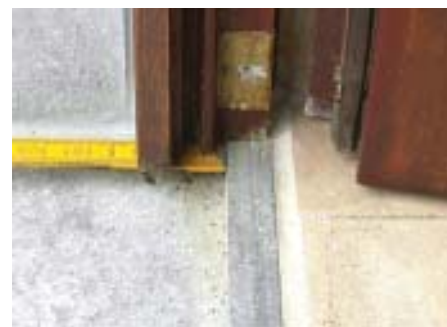
Afb. 2 Correcte plaatsing van de deurdorpel : contact tussen de guillotineplint en de opkant, zodat het water afvloeit voor de opkant.
