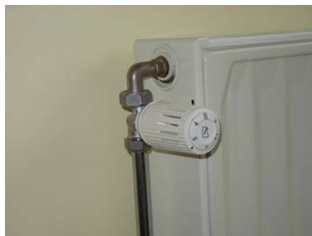
Afb. 2 Thermostaatkranen : een eenvoudige oplossing voor de warmteregeling in elke ruimte.
