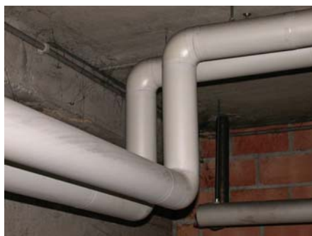
Afb. 1 Thermische isolatie van leidingen die buiten het beschermde volume gelegen zijn.
